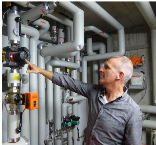
Energieberater Torsten Merker bei der Besichtigung der technischen Anlagen
